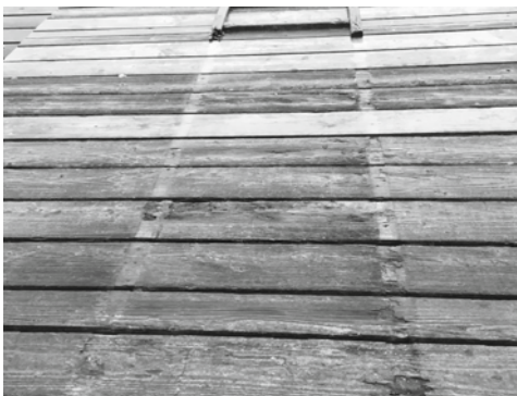
Maroder Zustand des oberen Bereiches der Jollenslipanlage
